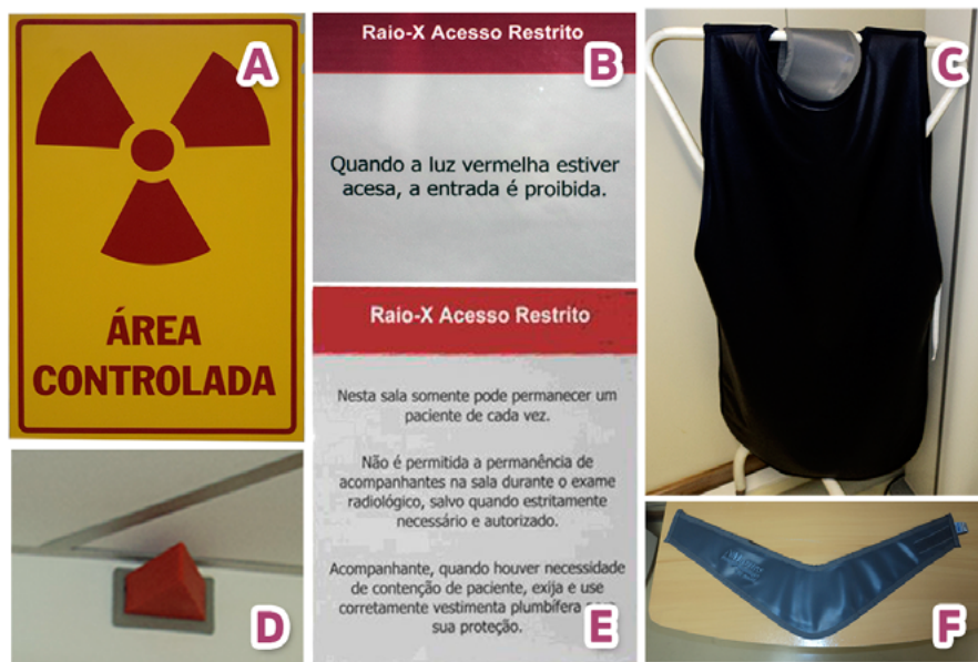
Figura 73. Sinalizações para sala de exames. Em A, símbolo internacional de radiação ionizante; em B, aviso de entrada restrita; em C, avental plumbífero apoiado em suporte; em D, sinalização luminosa de indicação que o aparelho está em uso; em E, avisos para acompanhante; em F, colar para proteção da tireoide
