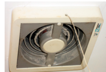
Figura 82. Exaustor da câmara escura precisando de limpeza Fonte: Acervo SQRI.
